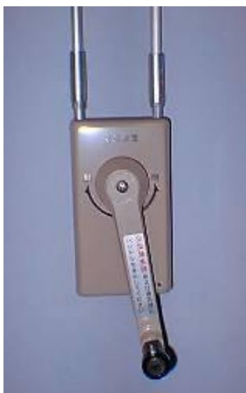
写真5 排煙装置手回し
