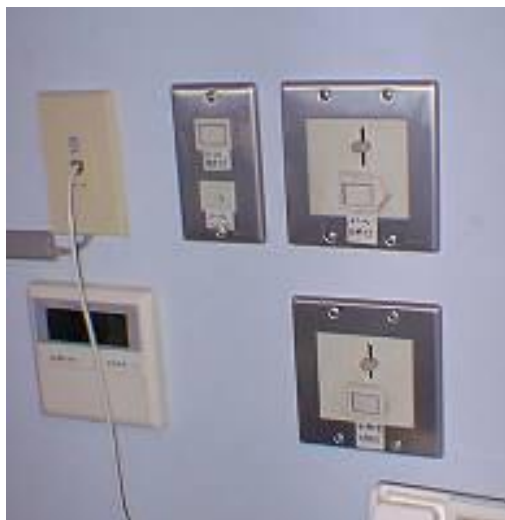
写真4 ドーム内照明のスイッチとエアコンのスイッチ
